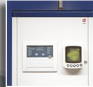
Brandmelde- und Löschanlagen
